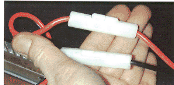
Les fusibles disposés directement sur les fils d'alimentations.
